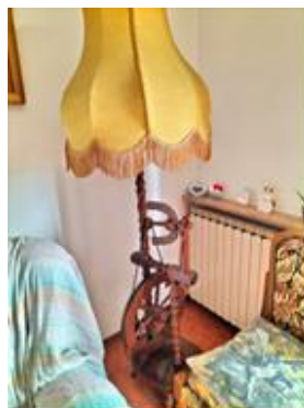
particolare imp. risc.
